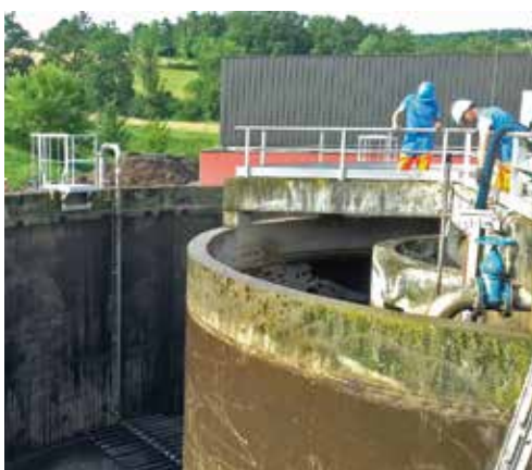
L'entreprise Suez est intervenue pour changer les rampes d'aération de la station de Marcillac-Vallon (en bas au centre de l'image).
